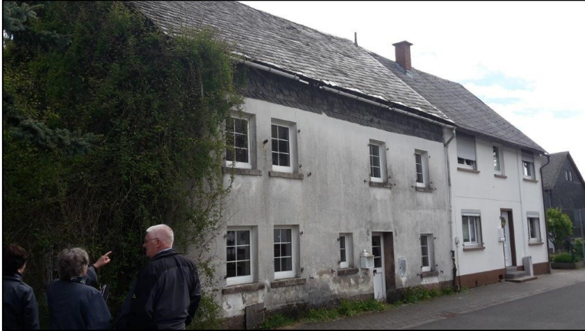
Problemanwesen Talstraße 18: Sehr schlechter Zustand, Gefährdung der Öffentlichkeit und
